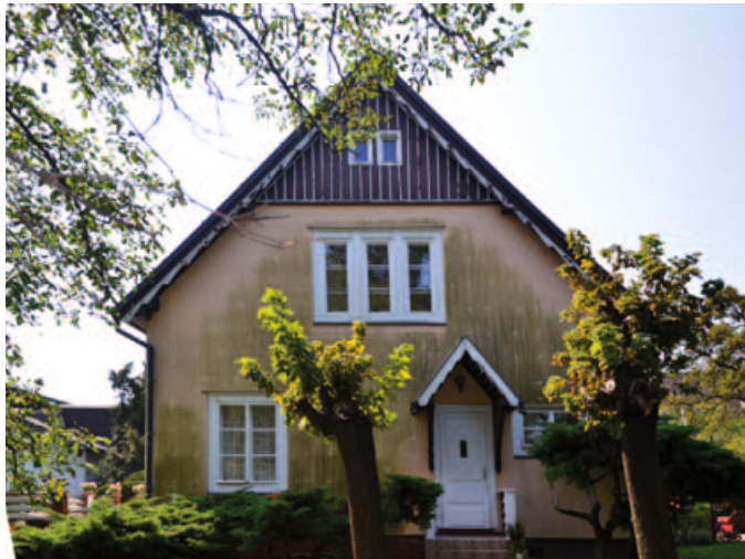
Napadnutá severná strana domu
